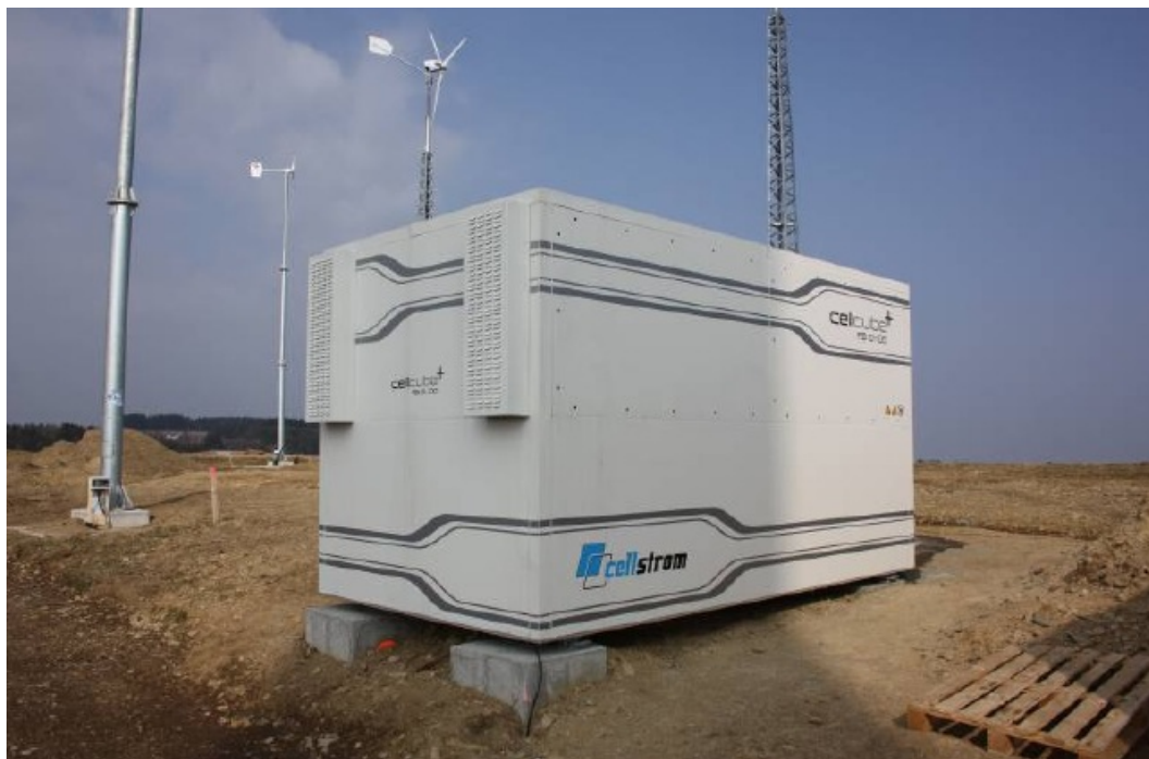
Abbildung 5: Vanadium Redox Batterie
