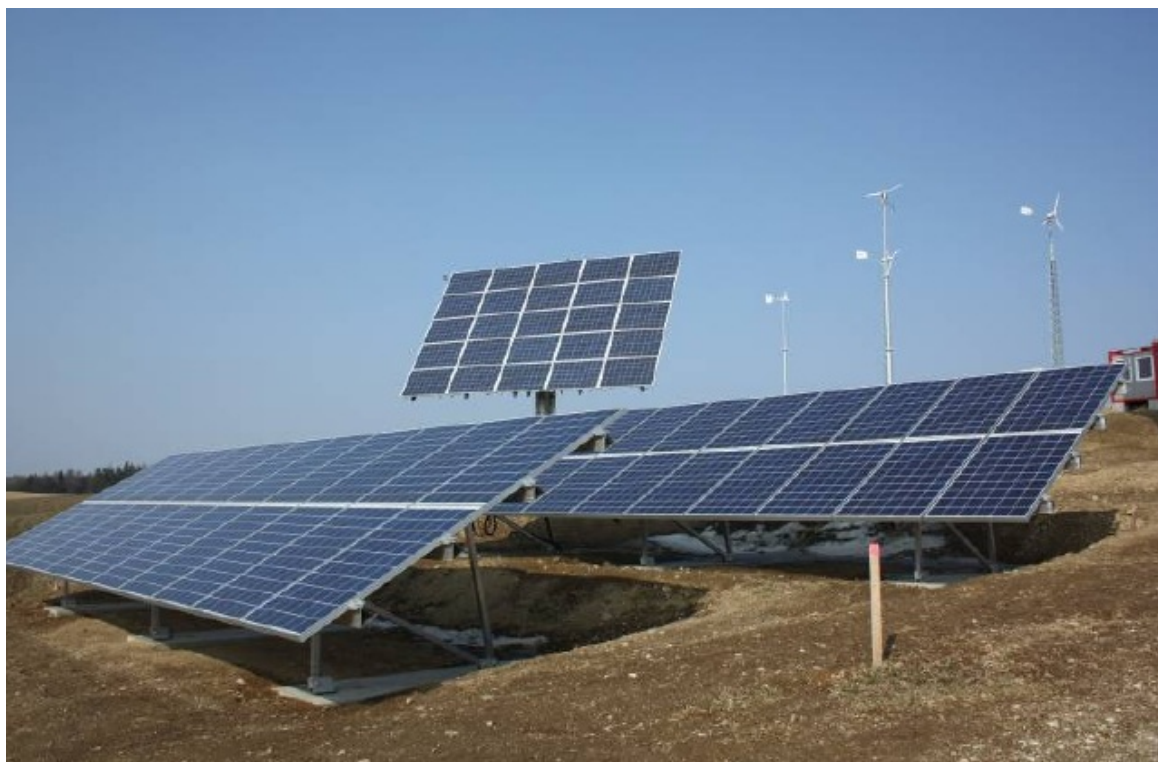
Abbildung 4: PV Anlage: im Vordergrund 10 kW fix aufgeständert und im Hintergrund 5 kW nachgeführt
