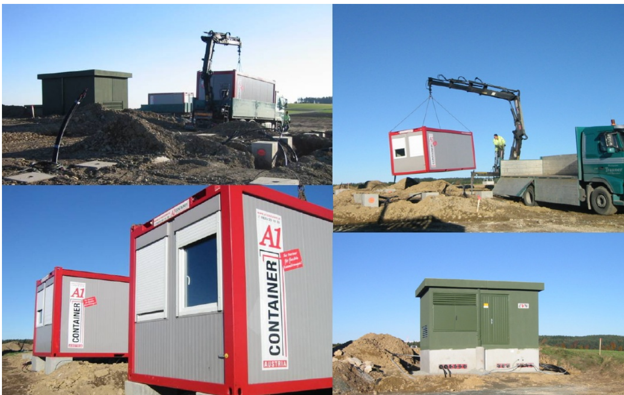
Abbildung 2: Aufbau der Infrastruktur (Trafostation, Messcontainer)
