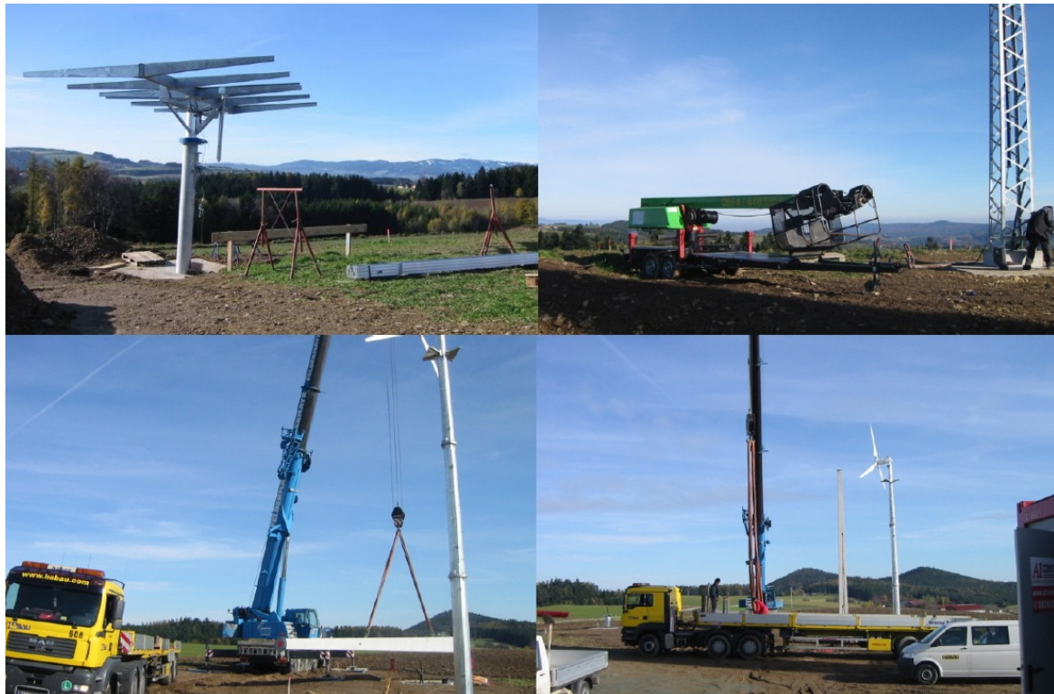
Abbildung 3: Aufbau der Infrastruktur (PV-Tracker, Windrad)
